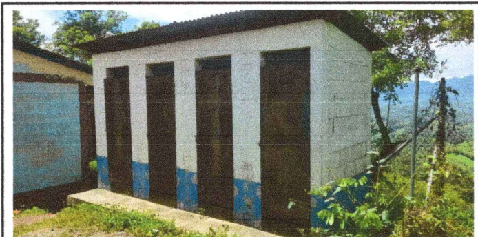
Foto 6: La puerta del baño esta en mal estado.
